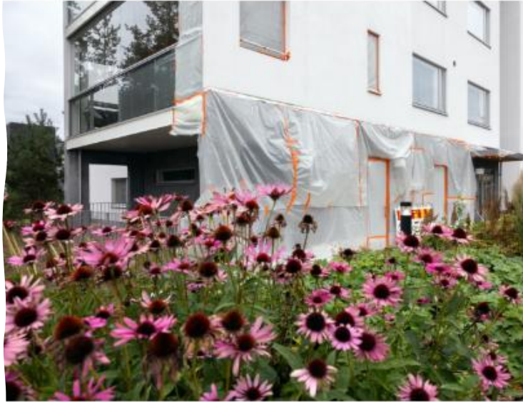
oon Koukkuniemessä sijaitsevassa kerrostalossa paikallisten ulkoseinän saumoja ja rappausta. Kuva: Matti Piletola / HS
